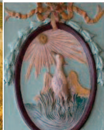
FENIKS Het oude fresco op de schouw is al door vocht aangetast.
